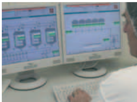
Leitstelle für das Tanklager Allegro im Teamleiterbüro. Visualisiert wird im Rahmen von PCS 7/Batch mit Windows Control Center (WinCC) von Siemens Automation and Drives.
