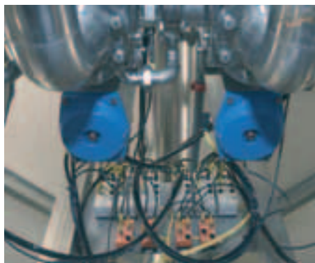
Tank-Einlagerungsventile mit zugehörigen I/O-Modulen: ASI-Airbox (hellgrau) mit zwei Pneumatik-Pilotventilen und Eingängen für die Prozessventil-Rückmeldungen; ASI-Eingangsmodule (orange) für die Überwachung der Molchsensoren.
