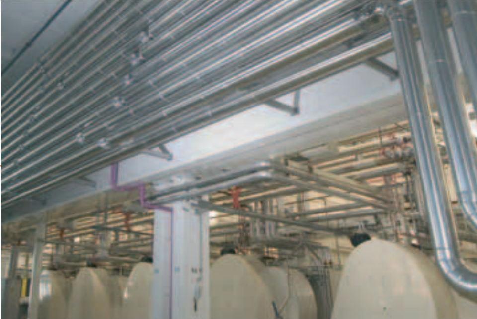
Leitungstrasse zwischen dem Schokoladenmassen-Tanklager Allegro und dem den Abfüllstrassen vorgelagerten Ventilknoten.
